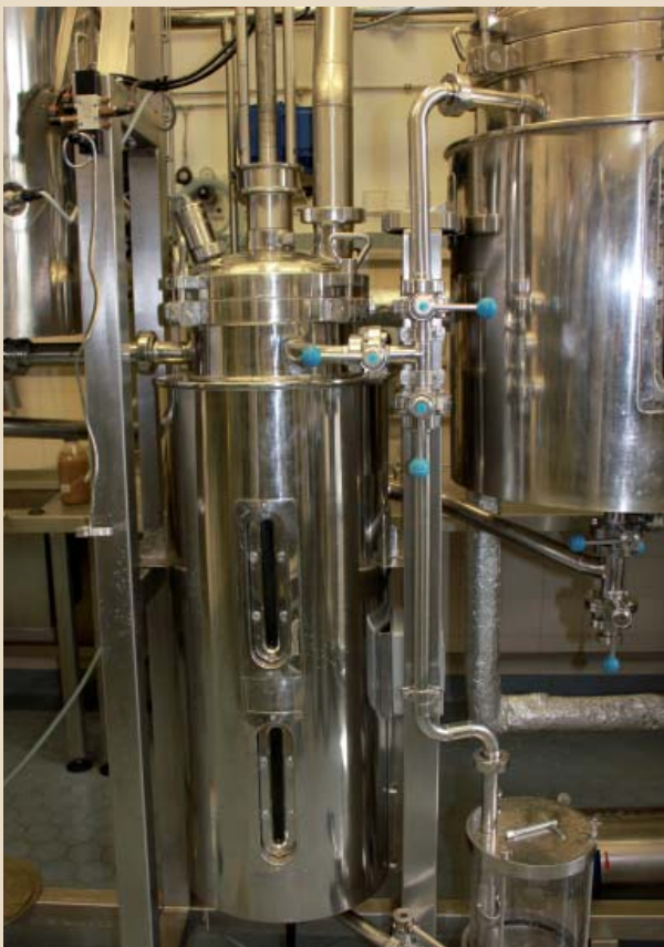
Abb. 2 Vor der Automatisierung wurden viele Regelventile manuell eingestellt Quelle: BLQ
