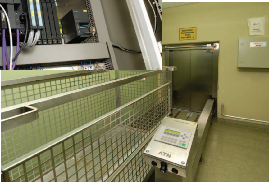
SPS und Operator Panel integriert: Die Komplettsteuerung Simatic C7-621 bewältigt alle Aufgaben eines 2-Platz-Speichers.
